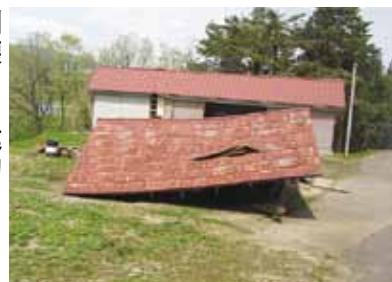
倒壊した建物
